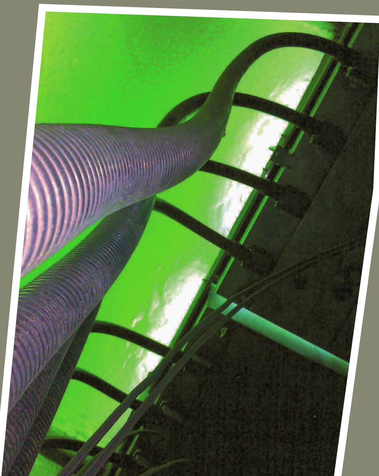
Canal de désinfection par UV à la station d'épuration du sud-ouest à Saint-Pétersbourg (Russie)
