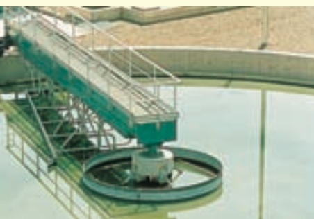
Assainissement des eaux usées
