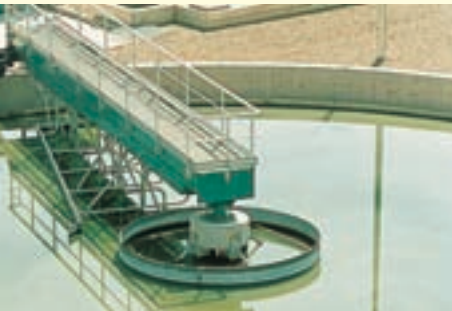
Klärung von Abwässern
