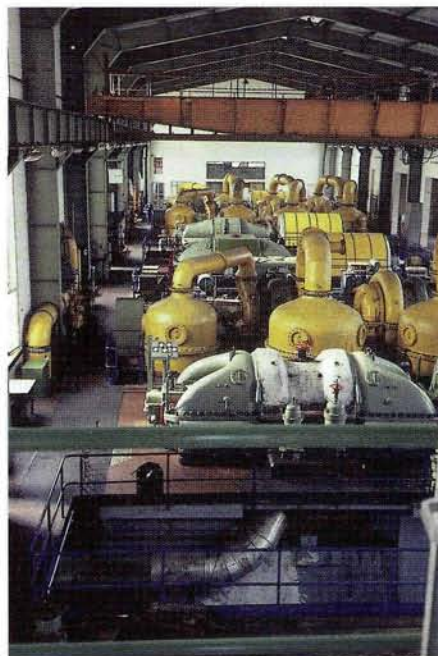
Jordvärmekraftverk i Lateraområdet (Latium) i Italien
