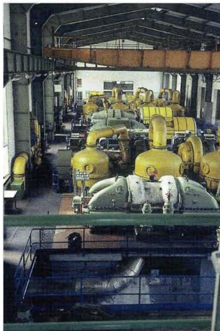
Centrale geotermica vicino a Latera (Lazio)
