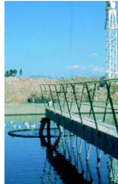
Kläranlage, Republik Südafrika
