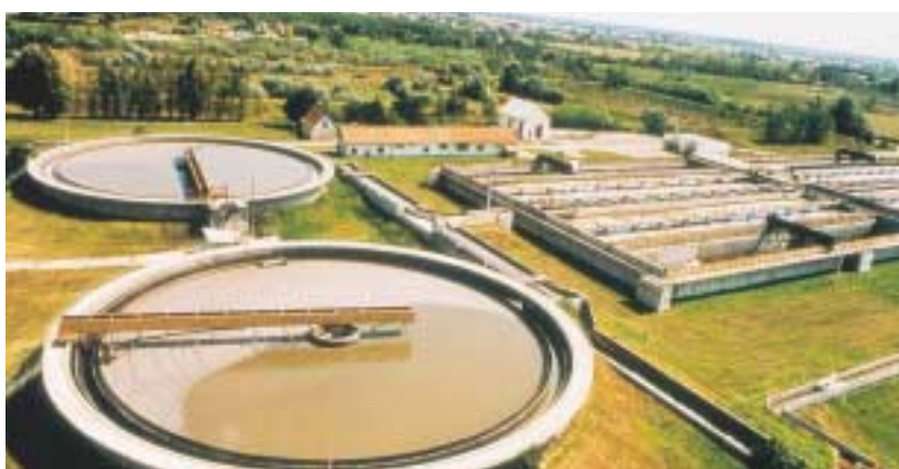
Station d'épuration, Debrecen, Hongrie
