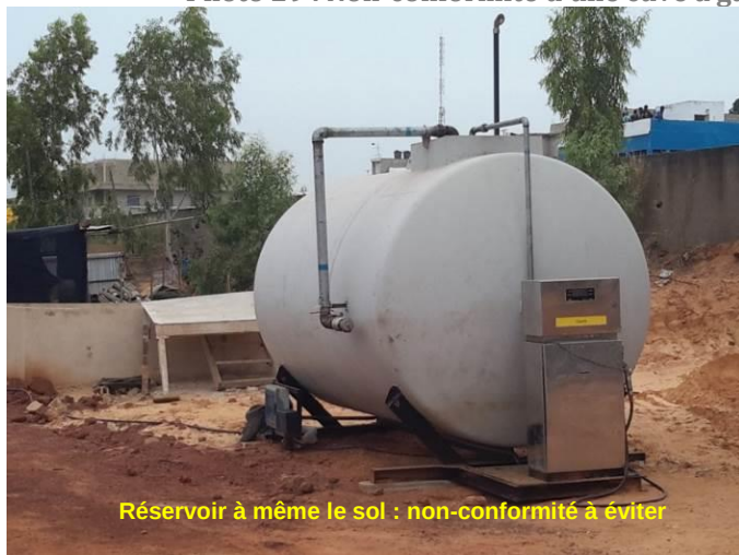
Photo 29 : Non-conformité d'une cuve à gasoil notée dans une base de chantier
