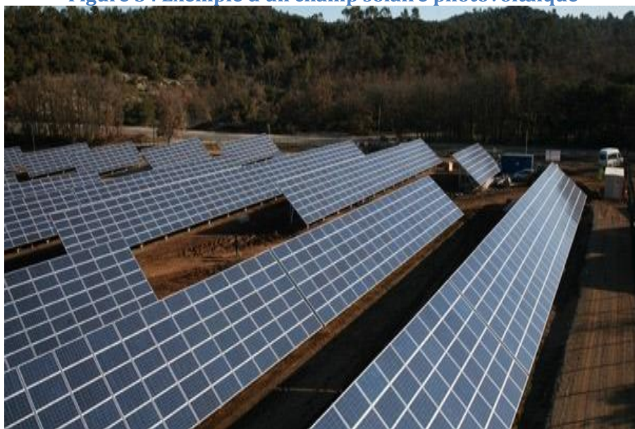
Figure 3 : Exemple d'un champ solaire photovoltaïque
