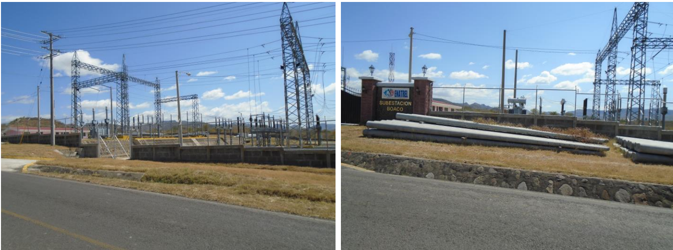
Figura 5.9 Instalaciones de una subestación, tomada de EIA SE Aeropuerto y obras conexas
