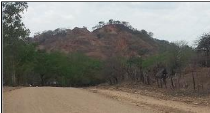
Cortes de talud susceptibles a deslizamientos
