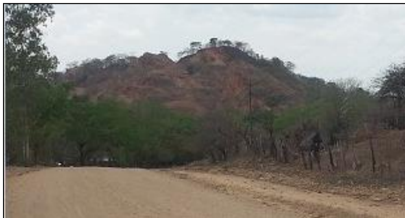
Cortes de talud susceptibles a deslizamientos
