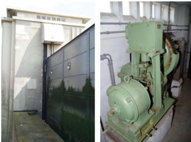
Afbeelding 4.2 Hefschuiven en binnenwerk
