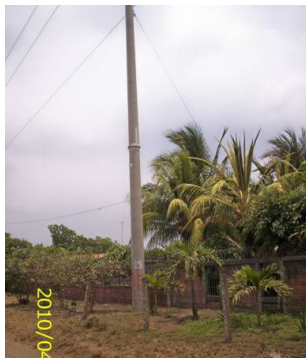
Poste en donde conectará la subestación
