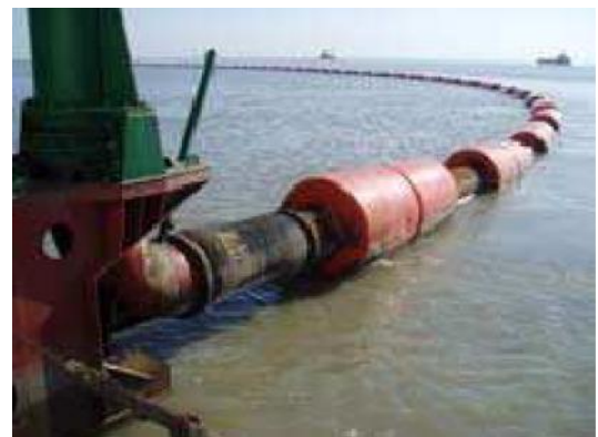
Figure III - 66 : Conduite flottante connectée à une drague aspiratrice refouleuse (source ISL, Ingérop)
