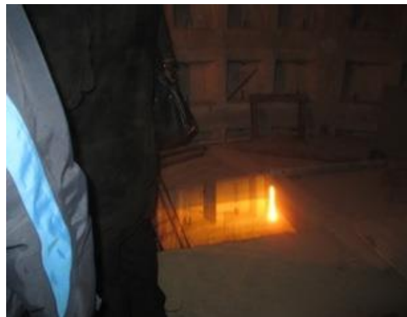
Рисунок 12. Отвори не огорожено. Погане освітлення робочих місць на станції «Перемога»
