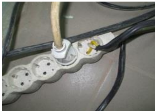
Рисунок 14. Використання електрообладнання на станції «Перемога»
