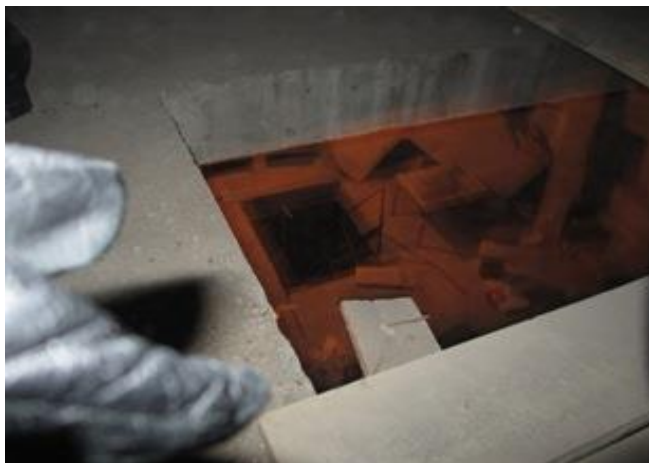
Рисунок 11. На станції «Перемога» не прикрито отвори
