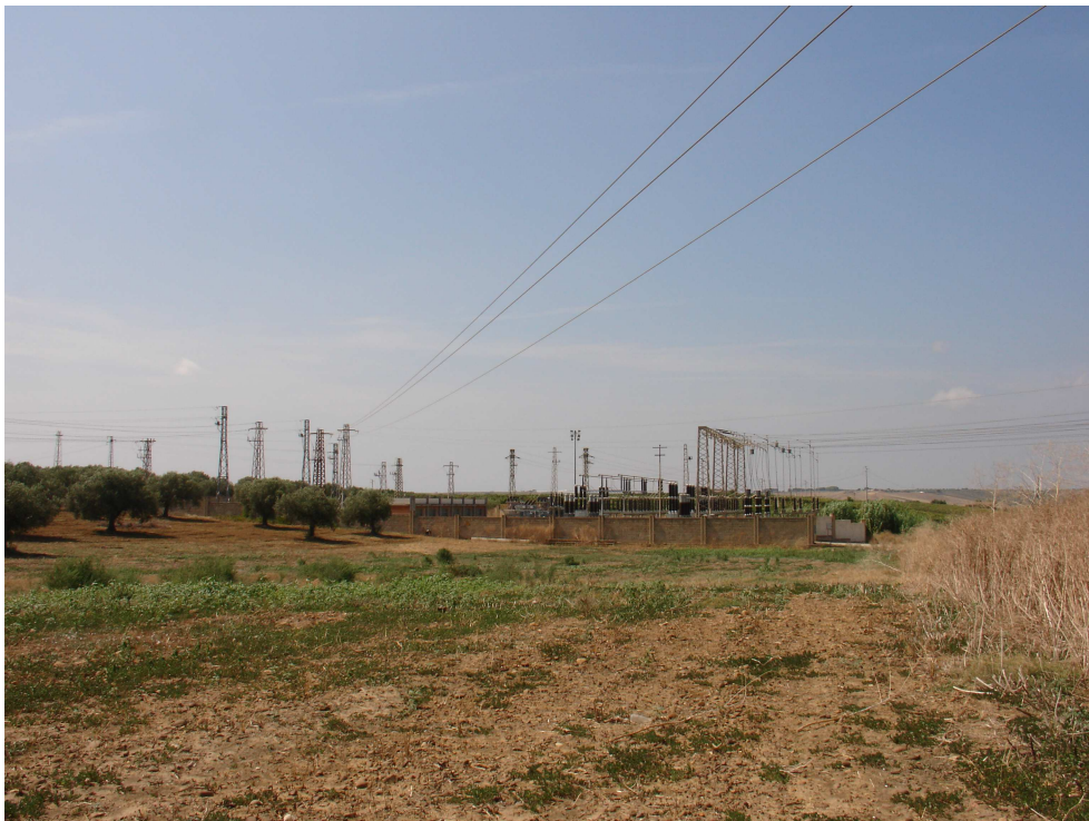
Figg. 3.4 – Cabina di consegna di una centrale eolica.
