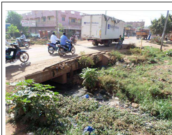
Drainage des eaux pluviales et usées vers le fleuve Niger (Plateau, Kalabancoro)
