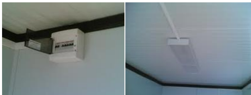
Imagen 21. Cuadro general de protección.
