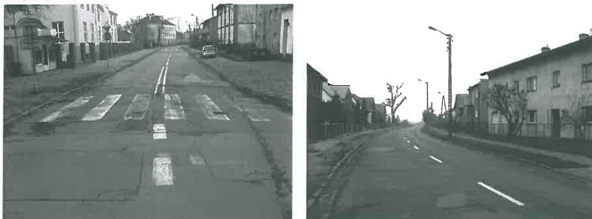
Fotografia 23,24 Nawierzchnia jezdni ul. Okulickiego
