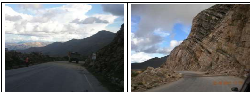
Foto 3.2: Inestabilidad de taludes sobre la Carretera Oruro – Cochabamba (próximo a la comunidad Sayari y Bombeo)
