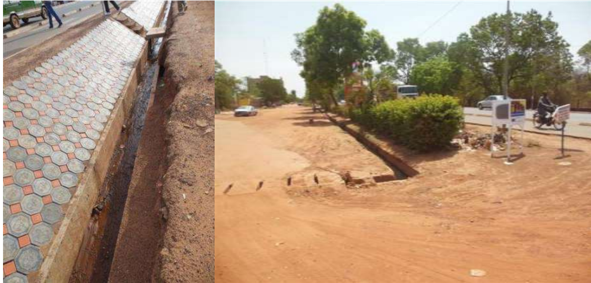
Figure 11 : Caniveaux de Ouagadougou, souvent encombrés par les ordures ménagères
