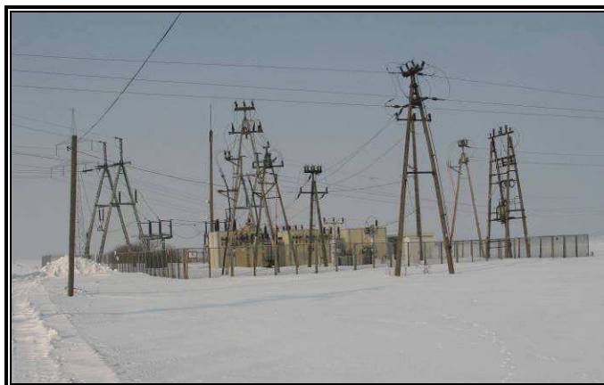
Fot. 3.15 Stacja transformatorowa w sąsiedztwie węzła „Stęszew”
