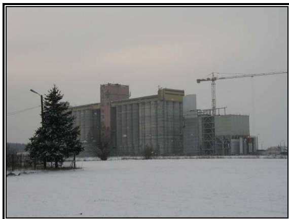
Fot. 3.51 Elewatory zbożowe
