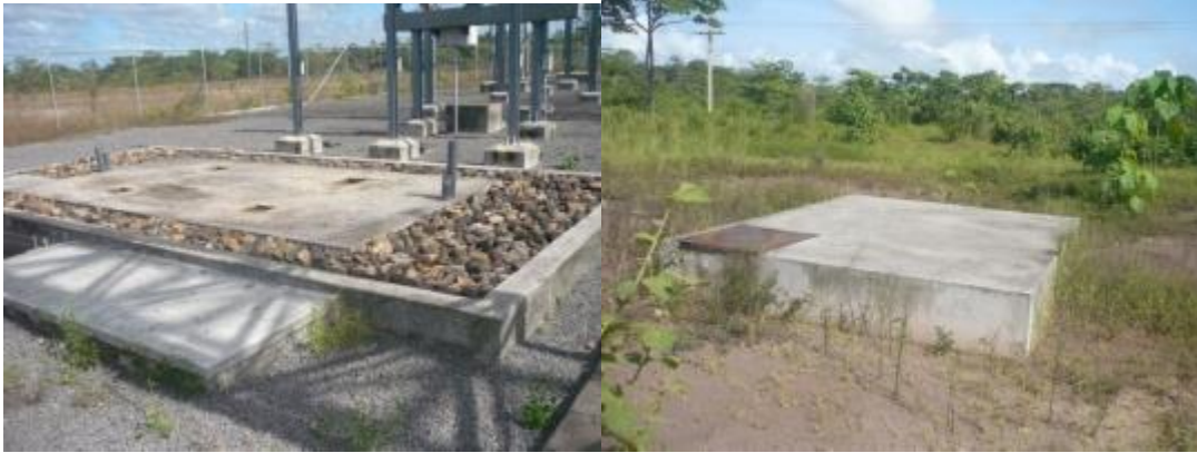
Figura 4.9. Fundación de la Bahía de Transformación de la SE Mulukukú donde se instalará el transformador y tanque de separación de aceite.
