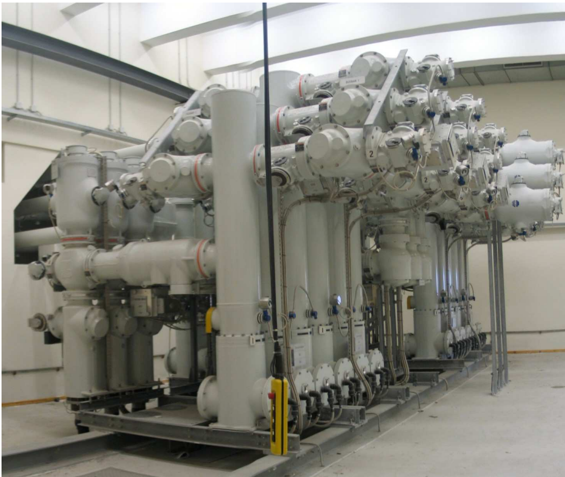
Φωτογραφία 1 Άποψη κυψελών και ζυγών 150kV τύπου GIS αντίστοιχου έργου
