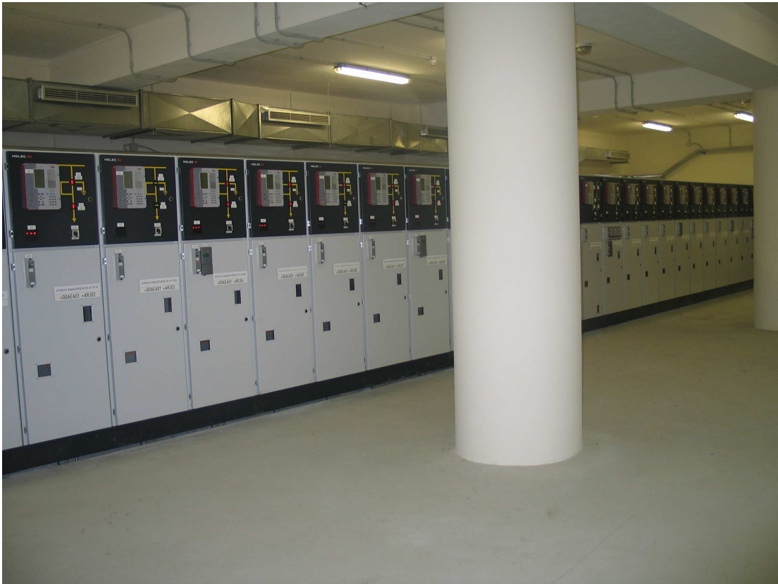
Φωτογραφία 2 Άποψη κυψελών Μέσης Τάσης 20kV αντίστοιχου έργου
