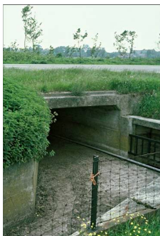
Przejście dla zwierząt małych pod drogą
