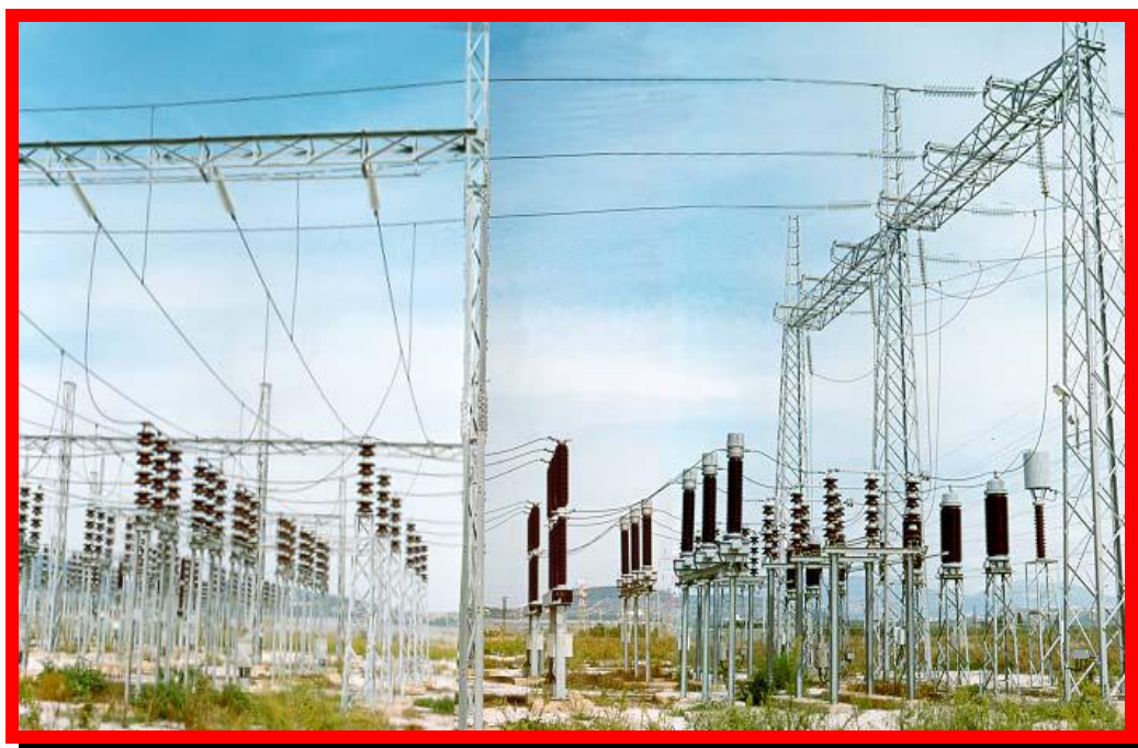
Εικόνα 4.1.2.2.5: Αποψη Κυψέλης Γραμμής Μεταφοράς 150KV
