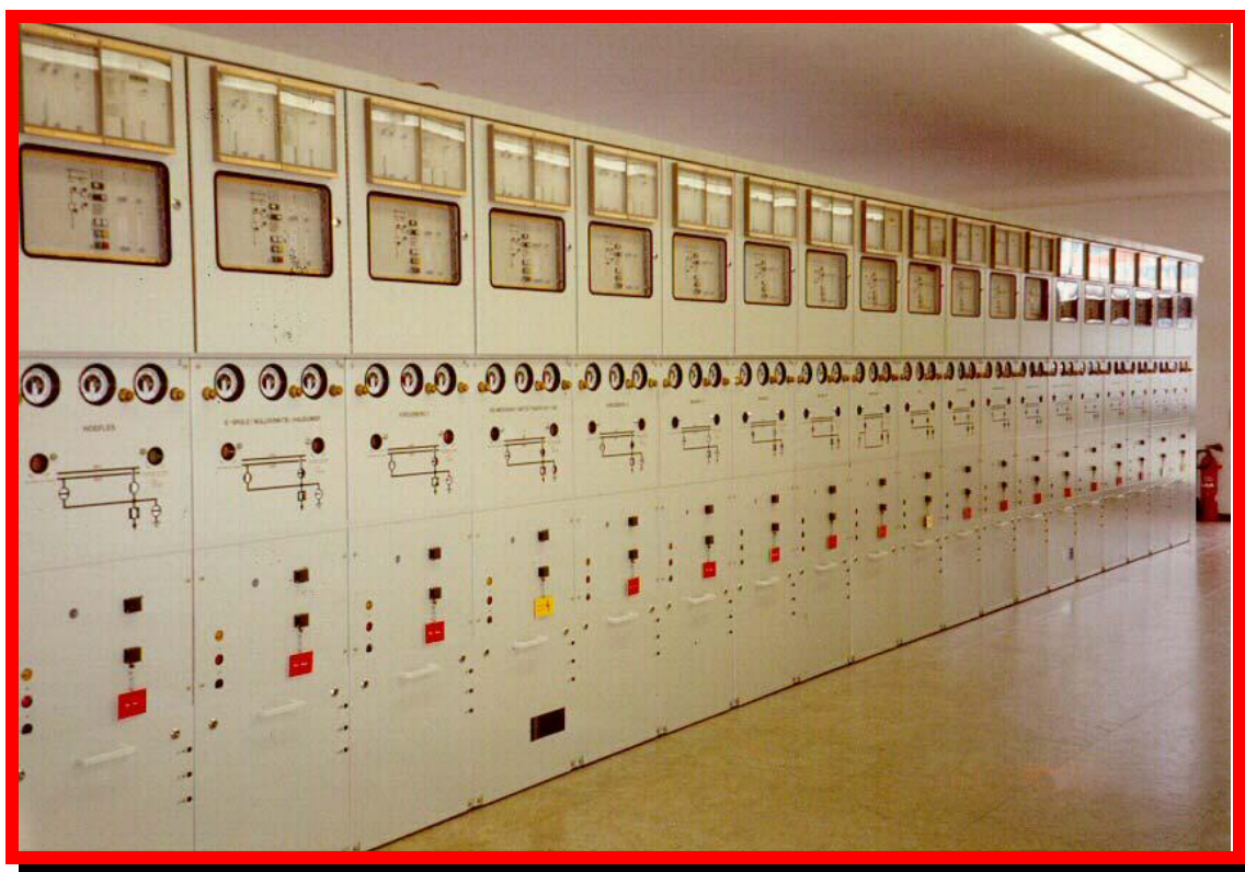
Εικόνα 4.1.2.2.1: Αποψη κυψελών Μέσης Τάσης
