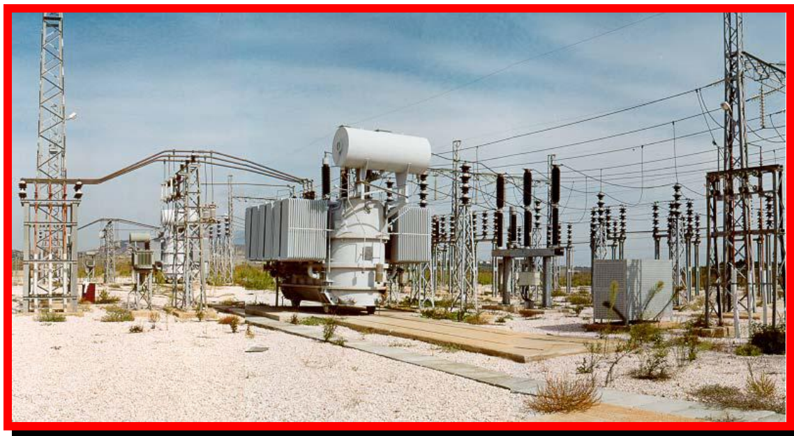
Εικόνα 4.1.2.2.3: Αποψη Κυψέλης Μετασχηματιστή Ισχύος σε τυπικό Υποσταθμό
