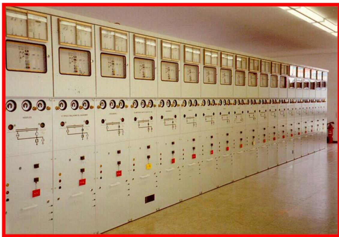
Εικόνα 4.1.2.2: Άποψη κυψελών Μέσης Τάσης
