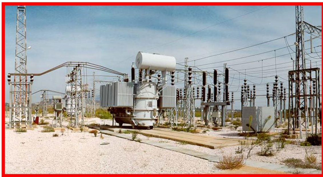
Εικόνα 4.1.2.3: Άποψη Κυψέλης Μετασχηματιστή Ισχύος σε τυπικό Υποσταθμό
