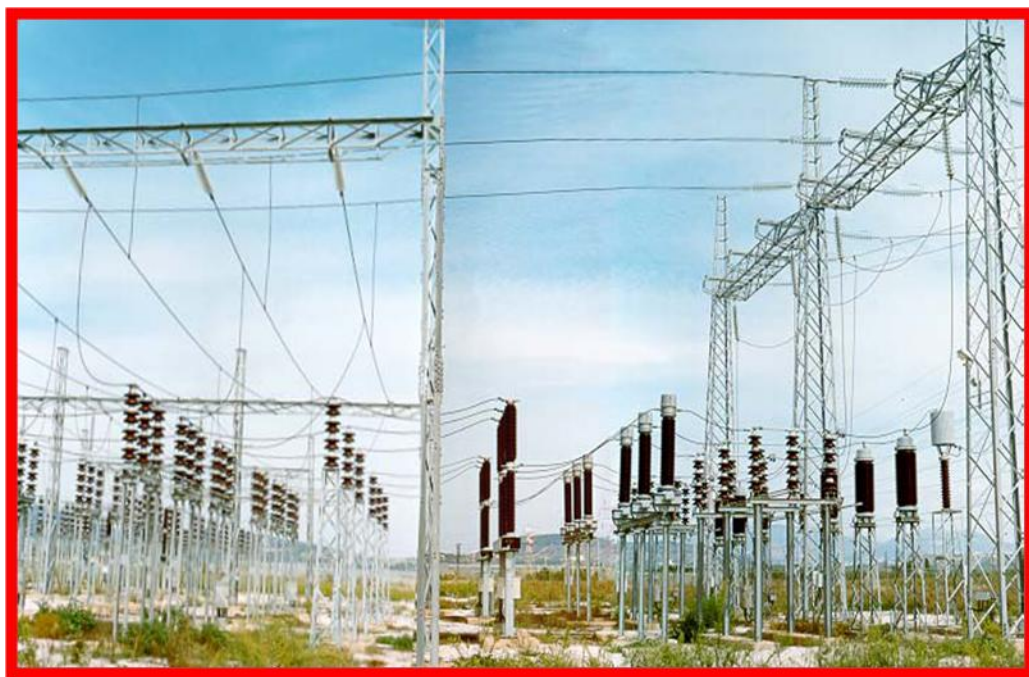
Εικόνα 4.1.2.4: Αποψη Κυψέλης Γραμμής Μεταφοράς 150KV
