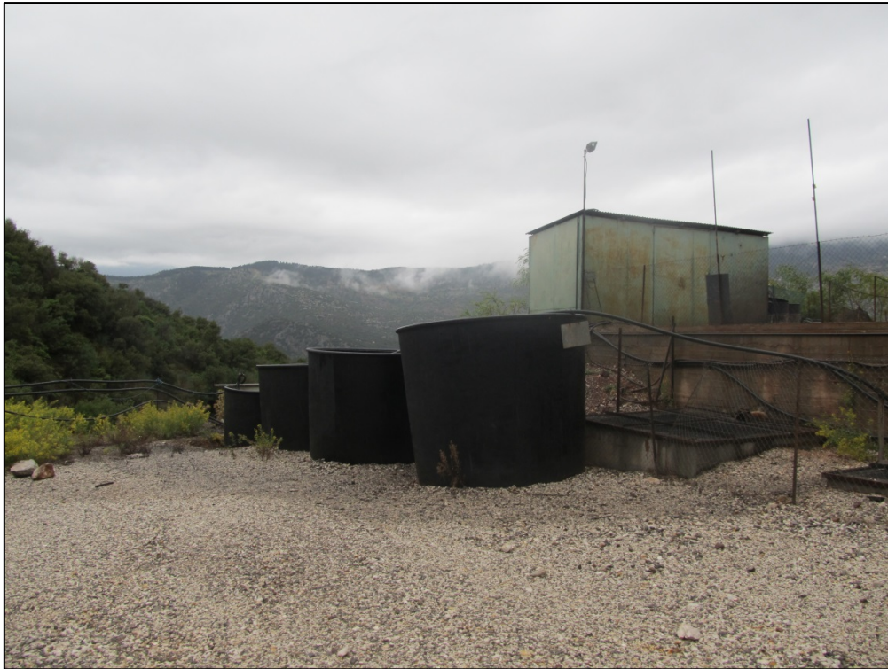
Φωτ. 5: Σύστημα διαδοχικών δεξαμενών καθίζησης στο χώρο του βοηθητικού συνεργείου
