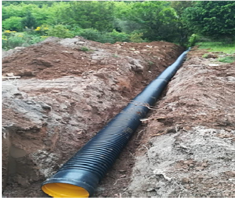
Εικόνα 3 : Σωλήνας για παροχέτευση νερού σε παρακείμενο ρέμα
