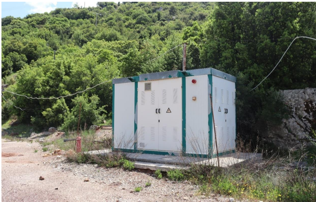
Φωτογραφία 3: Υποσταθμός ηλεκτρικής ενέργειας, Χώρος Α «54ΧΛΜ και 54ΧΛΜ/1»
