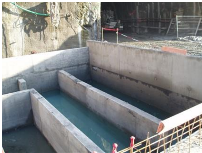
Bassin de décantation/déshuilage
