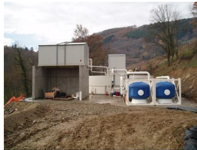
Centrale de traitement
