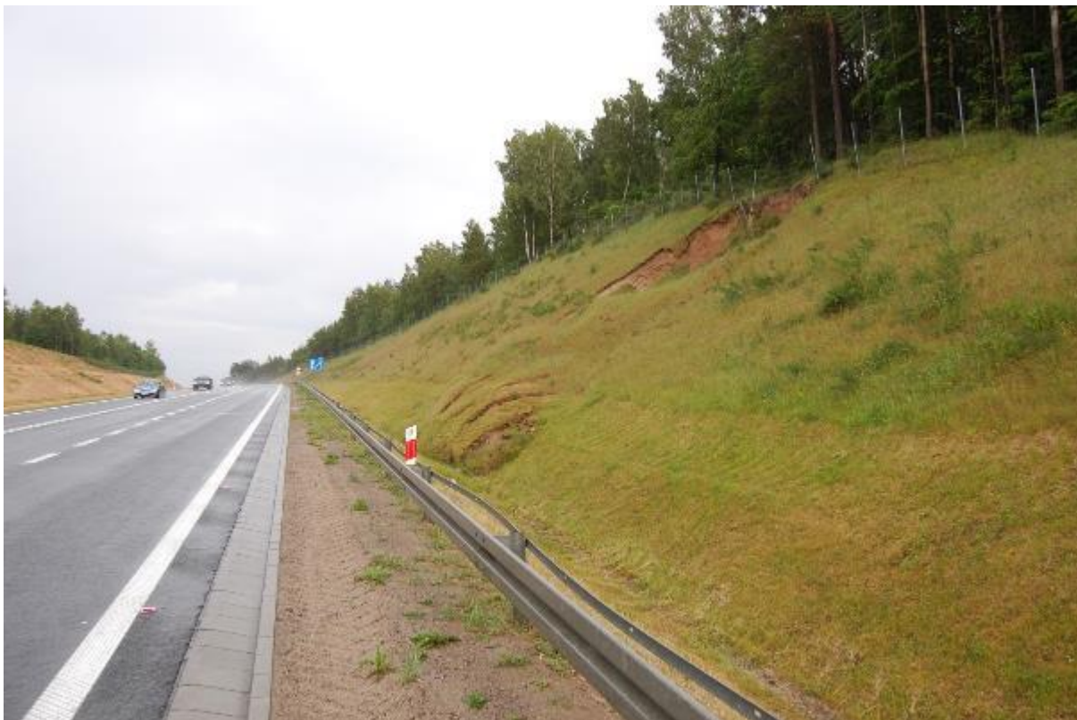
Zdjęcie 13 Osuwisko na skarpie drogowej
