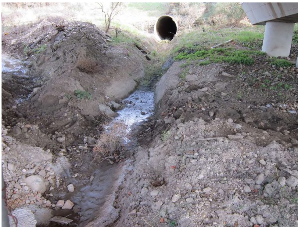
Figura 4-13. Condizioni del fosso sotto alla campata 2
