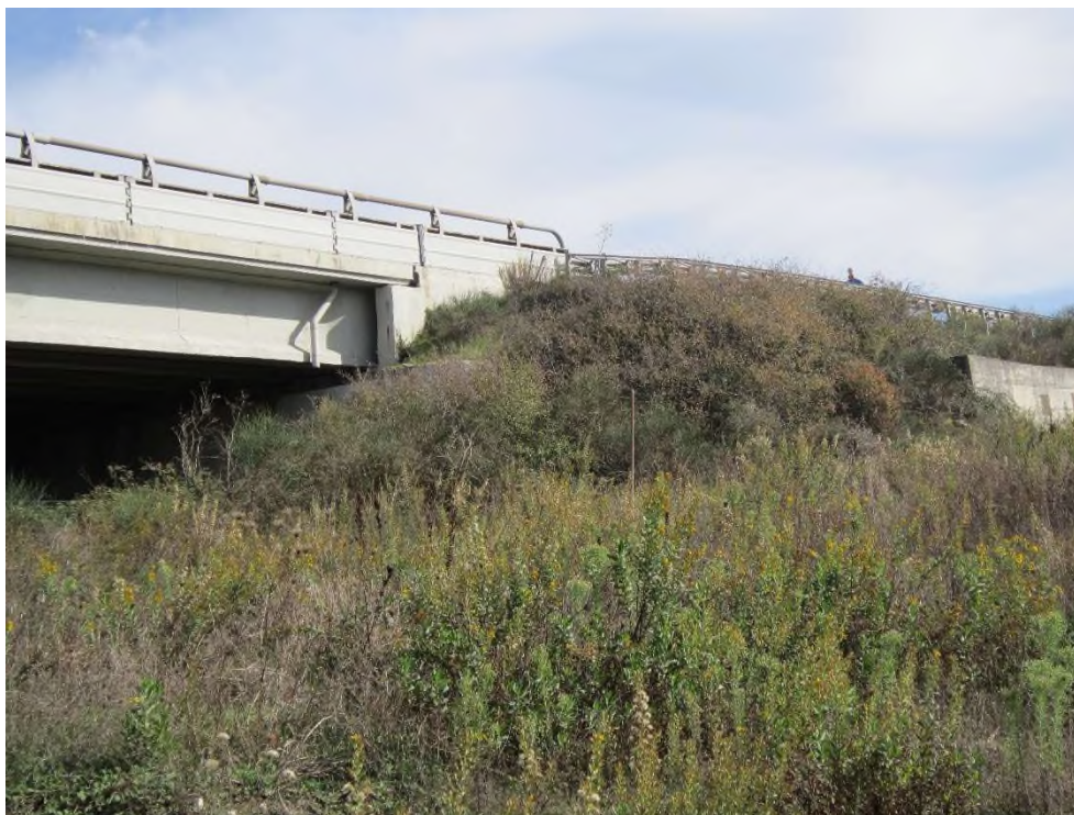
Figura 4-11. Condizioni della vegetazione e del suolo sulla spalla lato Bari
