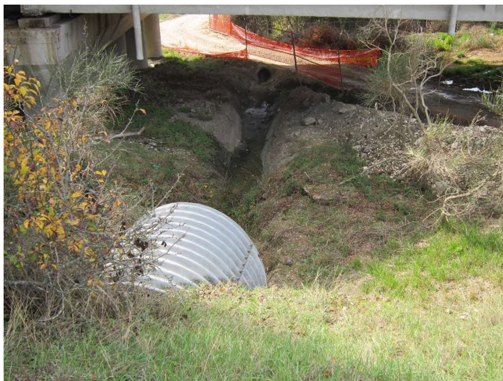
Figura 4-14. Condizioni del fosso sotto alla campata 2
