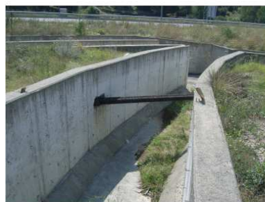
HMEPOM. 5/9/2016 Κανάλι διαχέυσης ομβρίων Εγνατίας Οδού στον κόμβο Πολυμύλου, μετά την έξοδο τεχνικού (βλ. Λεπτομέρεια 1 σχ. ZFSQ902) ΦΩΤ. 1-7 \\CRONOS\Share_Tidrasseis\112\ZFS\PHOTOS\2016-09-05\RIMG0008.JPG
