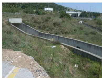
HMEPOM. 5/9/2016 Κανάλι διαχέυσης ομβρίων Εγνατίας Οδού στον κόμβο Πολυμύλου, μετά την έξοδο τεχνικού (βλ. Λεπτομέρεια 1 σχ. ZFSQ902) ΦΩΤ. 1-8 \\CRONOS\Share_Tidrasseis\112\ZFS\PHOTOS\2016-09-05\RIMG0009.JPG
