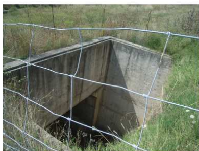
HMEPOM. 5/9/2016 Είσοδος φρεατίου συλλογής ομβρίων Εγνατίας Οδού στον κόμβο Πολυμύλου (βλ. Λεπτομέρεια 1 σχεδίου ZFSQ902) ΦΩΤ. 1-5 \\CRONOS\Share_Tidrasseis\112\ZFS\PHOTOS\2016-09-05\RIMG0006.JPG
