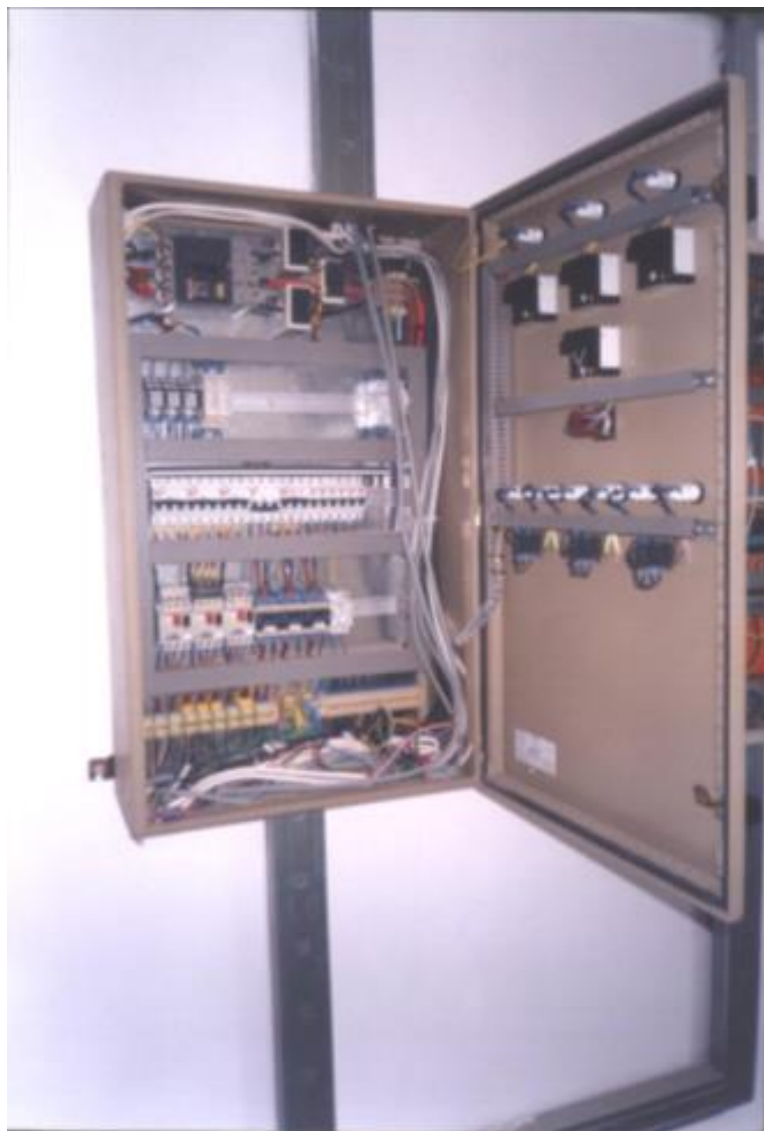
Εικόνα 2 : Πίνακας Αυτοματισμού Ισχύος
