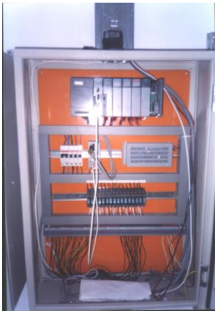
Εικόνα 1 : Πίνακας Αυτοματισμού PLC
