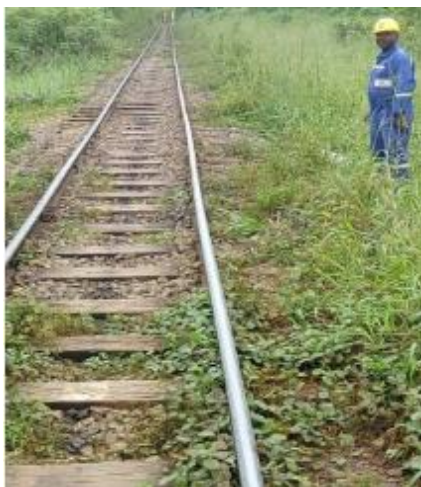
Photo 9. Voie en mauvais état : broussaille, défaut de géométrie, ballast insuffisant et pollué (Source groupement TEC-CUATRO/YUKSEL PROJE/INTEGC, 2021)
