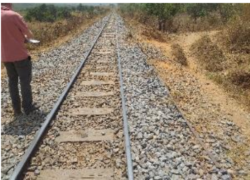
Plateforme rechargée de ballast en cours de perte de consolidation
