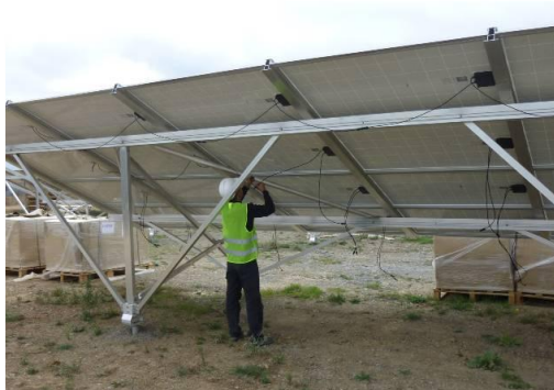
Figure 10: Câblage des panneaux
