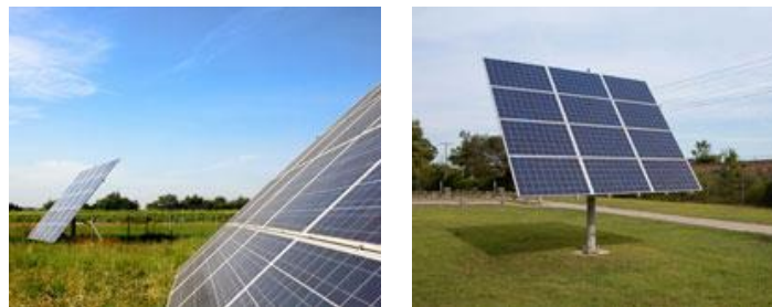
Figure 6: Panneaux photovoltaïques sur suiveur solaire
