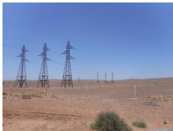
Figure 42: Lignes électriques passant à travers le site de Bouanane
