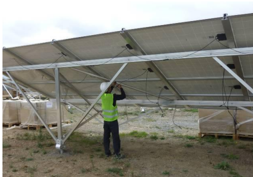
Figure 12: Câblage des panneaux
