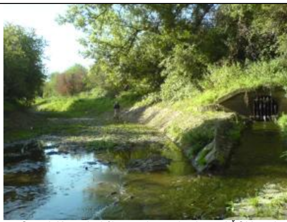
Soutok Kopaninského potoka s odpadem od ČOV, nad vyústěním vyschlé
