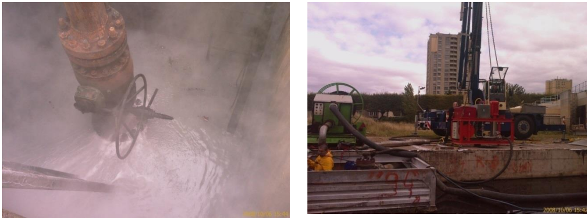
Figure 163 : Image d'une éruption en tête de puits et du dispositif mis en place pour la réparer.
