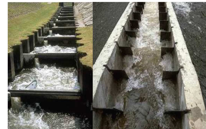
Figure 24 : Passe à poissons à fentes verticales, Méricourt (78) / Passe à ralentisseurs plans en Normandie (Source : VNF)
