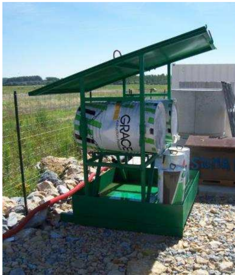
Photo 1 : Stockage de produits polluants à l'abri de la pluie (Source : chantier LGV Rhin-Rhône, setec)
