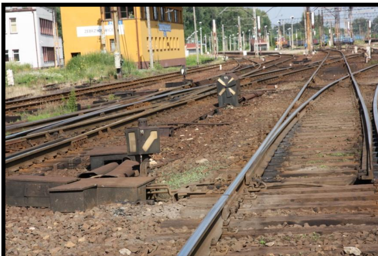
Zdjęcie 4-1 Stan nawierzchni torów a), b)
