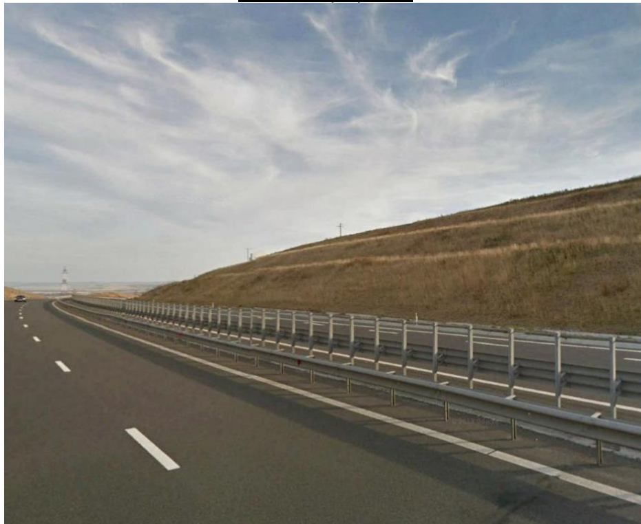
Fig.2.XX.Aspect din zona culoarului de conexiune ce intersectează traseul sectorului de autostradă Câpia Turzii – Gilău, dat în exploatare în anul 2009
