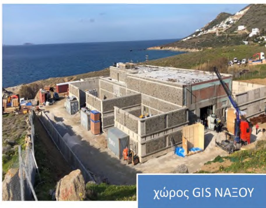
Φωτο 20 και 21. Χώρος υποσταθμού Νήσου Νάξου
