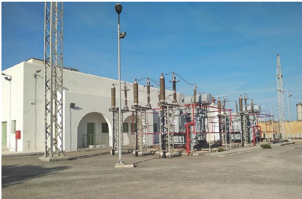
Σχήμα 6-7. Τυπική άποψη Υποσταθμού GIS 150kV/MT Πάρου
