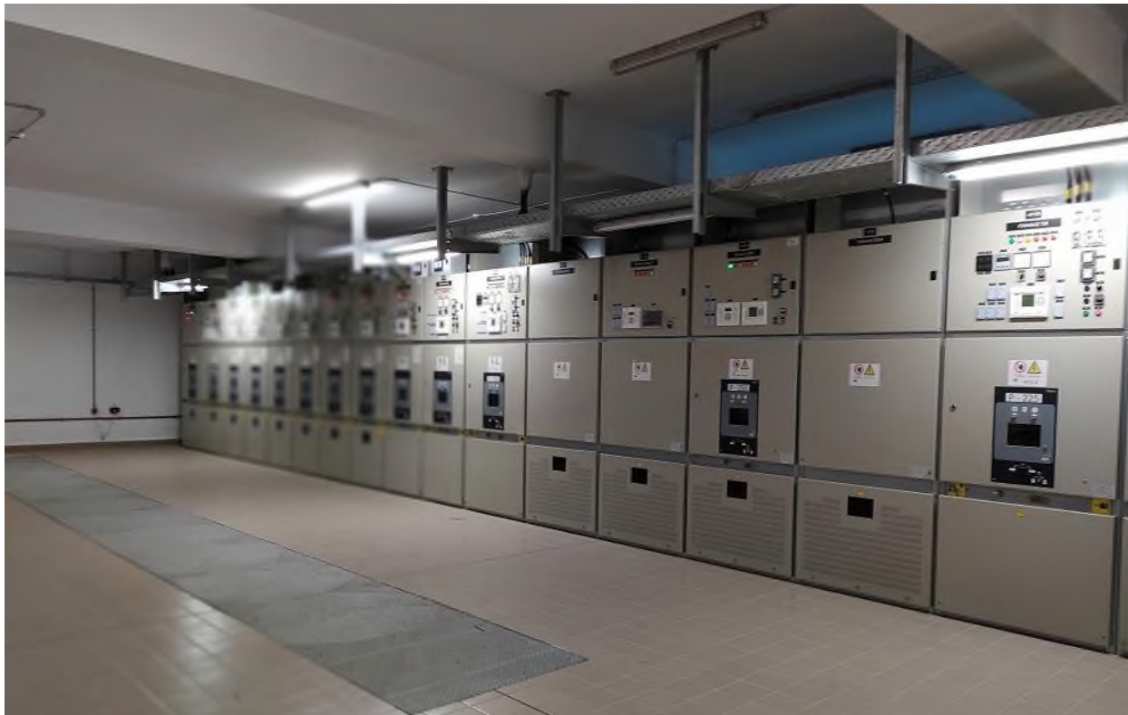
Σχήμα 6-6. Τυπική άποψη πινάκων Μέσης Τάσης 20kV GIS σε Υποσταθμό 150kV/MT
