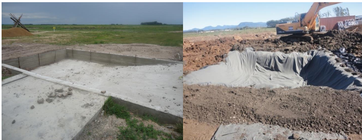
Figura 15. Exemplo de tanque de sedimentação (esquerda) com rampa em concreto e (direita) com geotêxtil.
