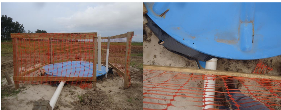
Figura 9. Exemplo de caixa d'água instalada como reservatório de efluentes com detalhe do cano coletor vedado.
