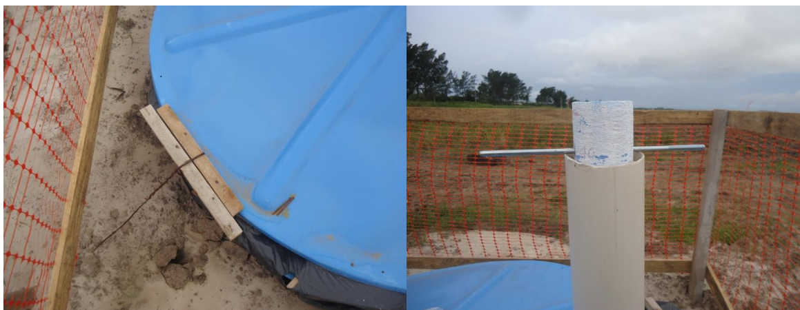
Figura 10. Exemplo de caixa d'água instalada como reservatório de efluentes com tranca em arame e madeira para vedar a tampa da caixa (esquerda) e medidor de nível em isopor (direita).
