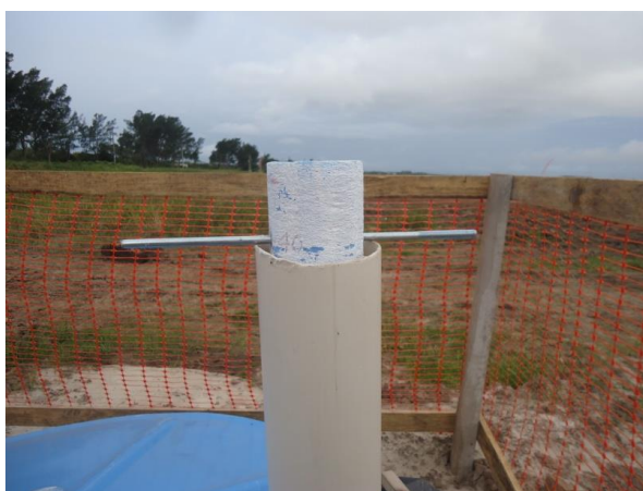
Figura 75. Medidor de nível em isopor.
