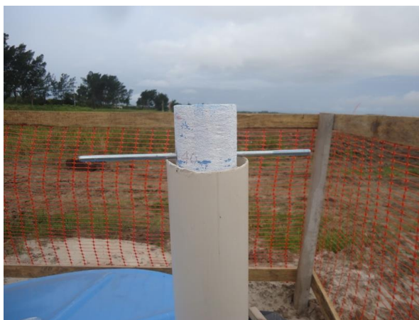
Figura 75. Medidor de nível em isopor.
