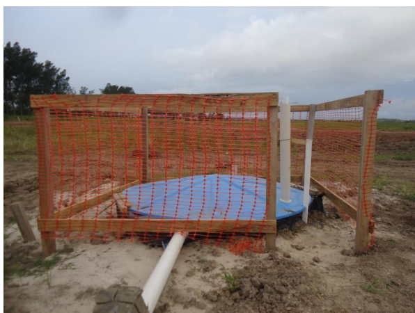
Figura 72. Exemplo de caixa d'água instalada como reservatório de efluentes.
