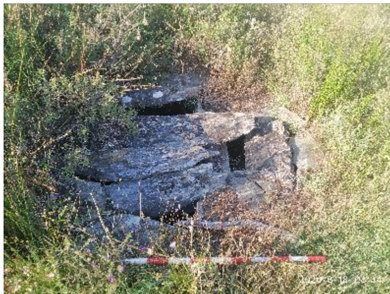
Foto del cerramiento del pozo, un poco peligroso al estar a punto de hundirse
