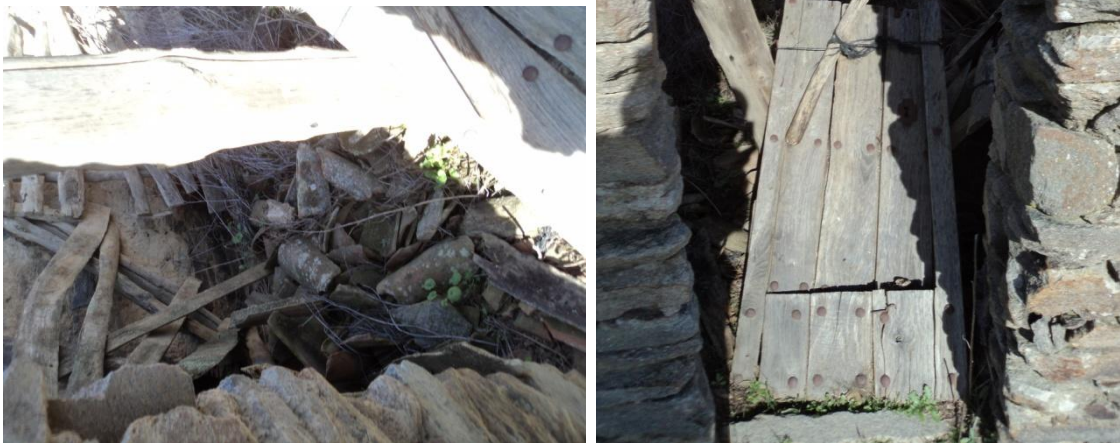
Figura 13 y 14: Presencia de algunos elementos de época contemporánea: casa de planta cuadrangular que en su tiempo estuvo techada a dos aguas con teja árabe sobre vigas de madera, y que actualmente se halla hundido.
