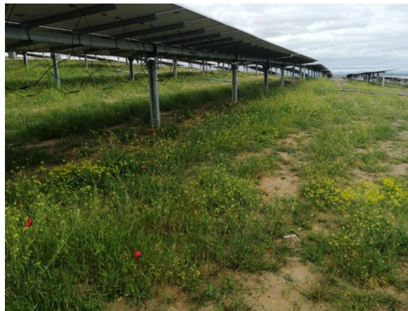
Imagen 1.a. FV de 50 MW en Bargas (Toledo). (2020). Fuente: Ideas Medioambientales.
